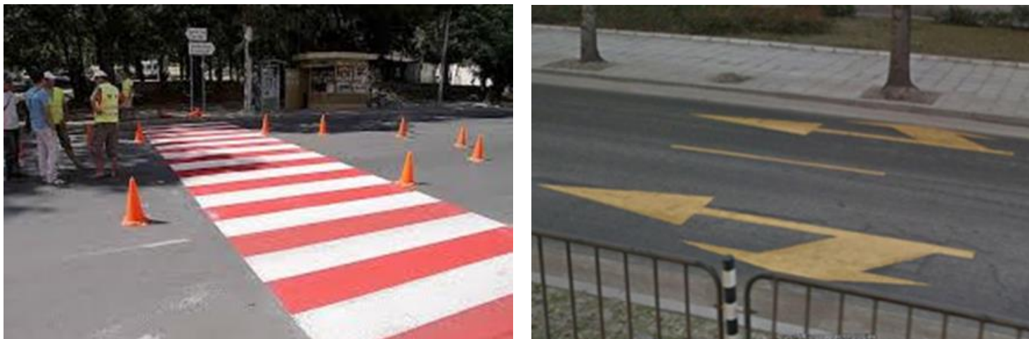
Фиг.1. Неправилно изпълнена пътна маркировка
